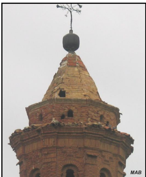
Estado actual de deterioro de la torre
