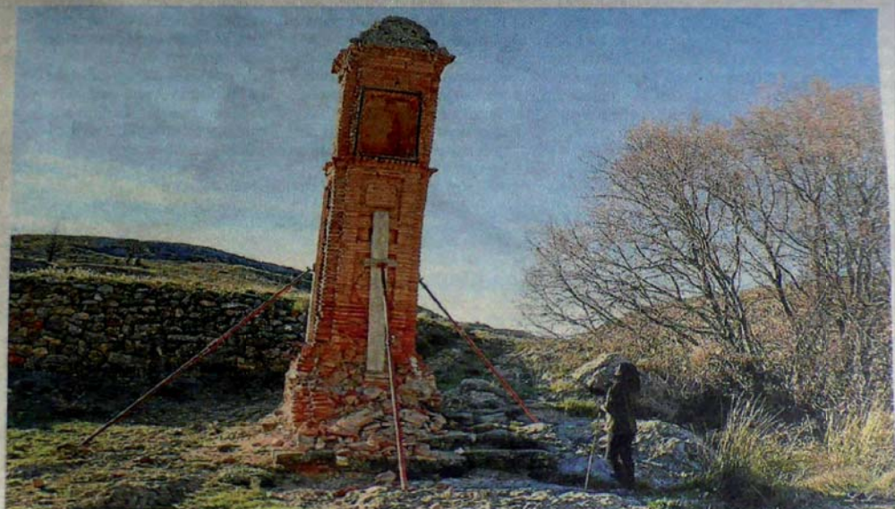
El peirón ha sido recientemente apuntalado tras sufrir el derrumbamiento de parte de su base. HA
