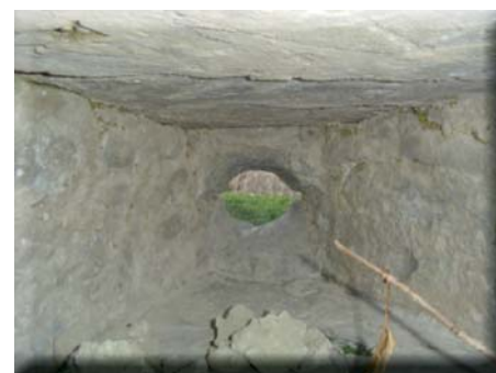
Figura 26: Palacio fortificado de Larrés (Huesca): interior de la tronera de la figura precedente. Se observa claramente la fuerte deriva lateral y las losas de la cubierta. Al fondo, la boca interna de la tronera.
