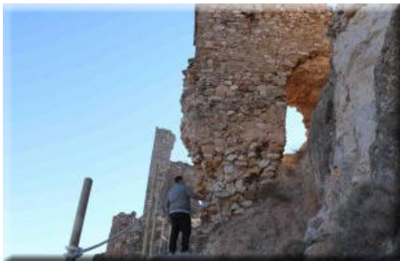
El alcalde de Huesa del Común, Jerónimo Gracia, muestra el lienzo del castillo que se va a asegurar para evitar el riesgo de su caída sobre el casco urbano
