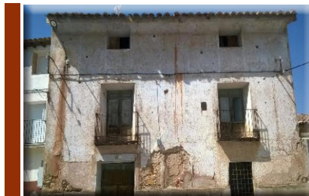
Restos oxidados de metralla procedente de una explosión cercana (incrustados en la fachada en la Plaza Vieja).
