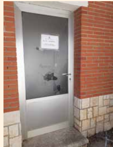
LAS PISCINAS Actuación debido al nuevo robo producido en las piscinas.
